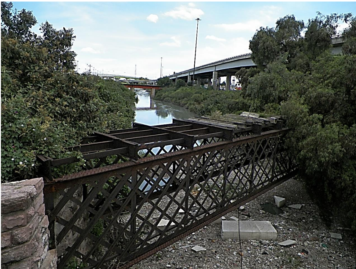
Foto 14. Estado actual del puente del Ferrocarril Hidalgo y Nordeste (Fotografía Guillermo Escobar, 2021).
