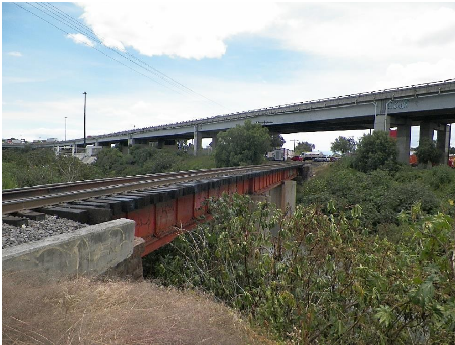
Foto 8. Puente del Ferrocarril Mexicano que se apoyaba originalmente en dos machones de mampostería en las orillas del Gran Canal al cual le añadieron cemento (Fotografía Guillermo Escobar, 2021).
