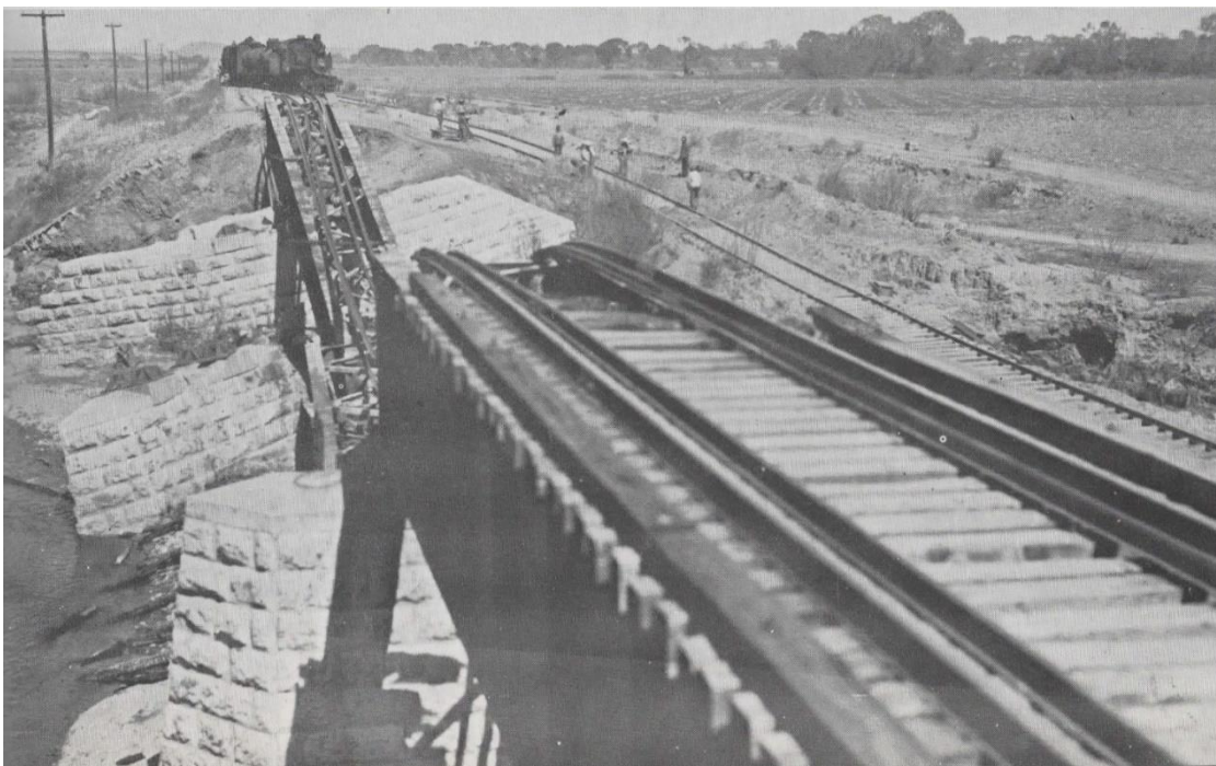
Foto 7. Puente de fierro del Ferrocarril Mexicano dinamitado por las fuerzas zapatistas el 10 de marzo de 1915 (Casasola Gustavo, Historia Gráfica de la Revolución Mexicana , T. III, p. 1005).
